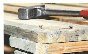
Einschlagen herausstehender Befestigungselemente
